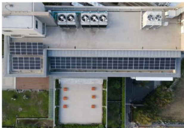
誠愛樓屋頂太陽光電發電系統
