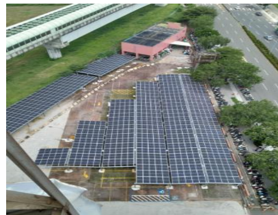
口腔大樓停車場即將完成地上太陽光電發電系統
