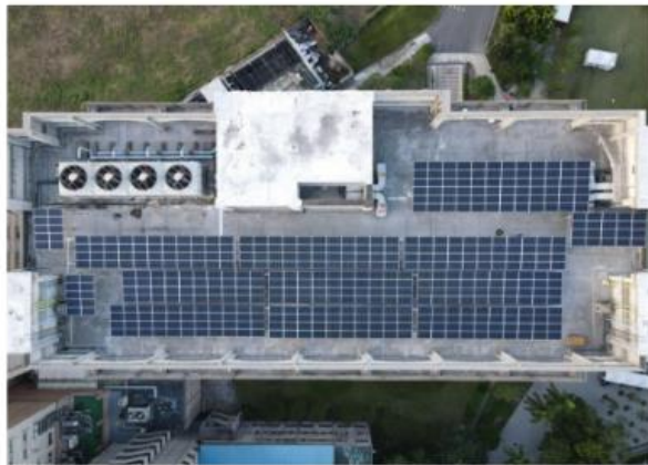
正心樓屋頂太陽光電發電系統
